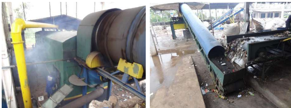
Figura 21 – Equipamentos para triagem dos RSDC no município de Iguatemi/MS.
